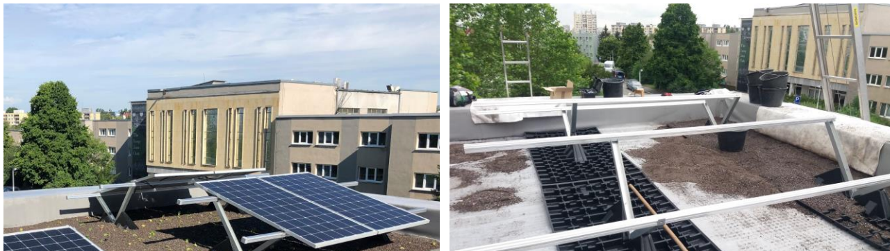
Obrázek 37: FVE lze kombinovat se zelenou střechou. Foto z realizace, zdroj: Jan Macháč (2021).
